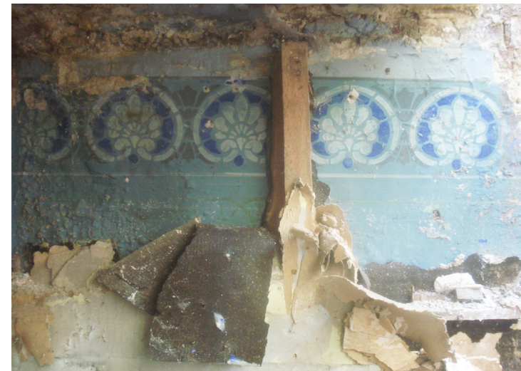
25. Провулок Кравцова, № 13. Напівпідвал, південна стіна. Руберойд, під яким збереглися первісні розписи від ремонтів та інших зовнішніх впливів. Світлина В. Романовського, 2019 р. (до стор. 266-278)
